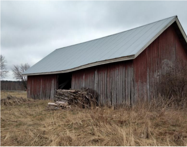
Kuva 118. Julkisivun maalipinta on huonokuntoinen.
