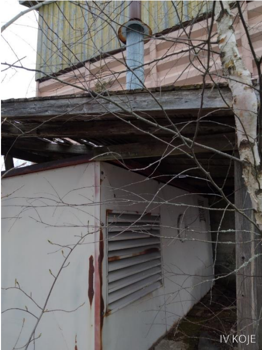
Kuva 58. Kuivauskone ja sen hormi.
