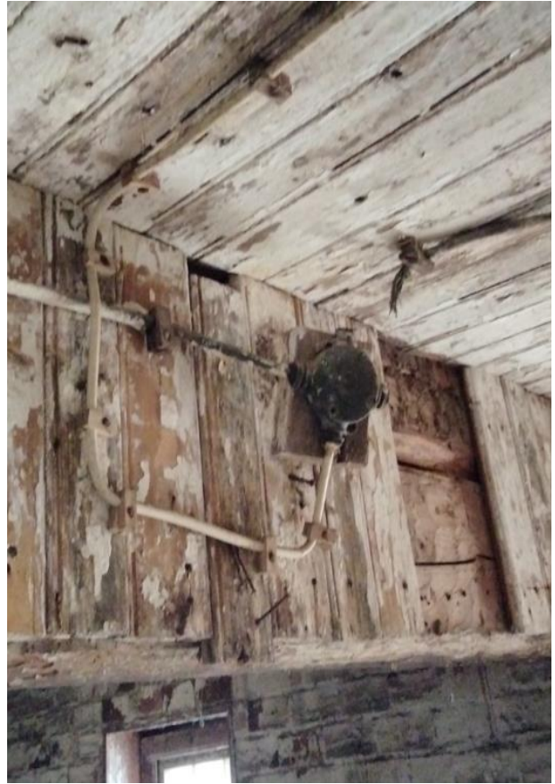
Kuva 30. Jakorasia irti seinästä ja kaapeli on irronnut liitoksesta.
