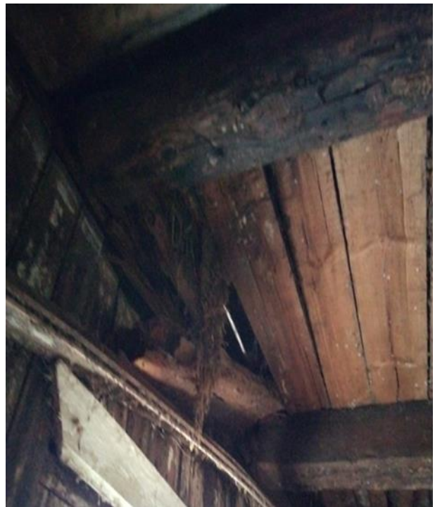
Kuva 26. Kattoa on romahtanut.
