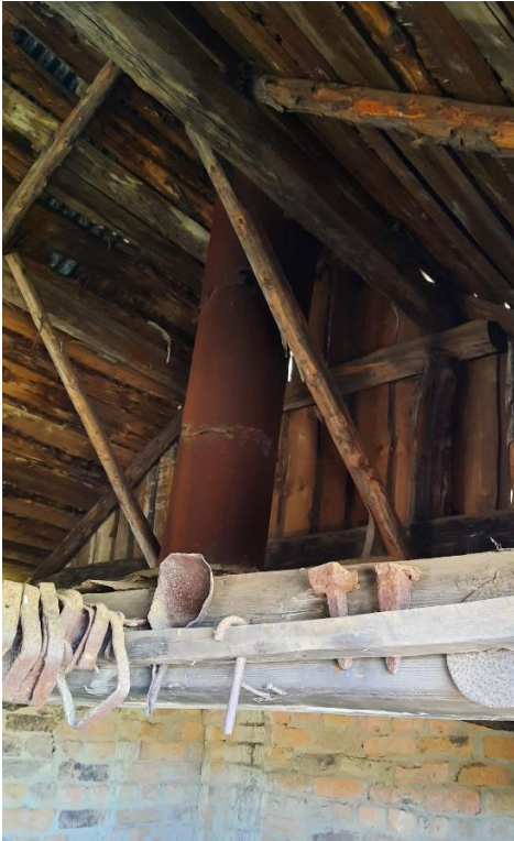
Kuva 37. Uuni metallinen hormi.
