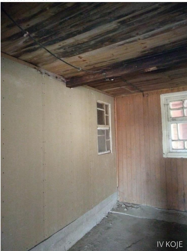
Kuva 114. Katossa vuotojälkiä. Myöhemmin tehtyä kipsilevyseinää.
