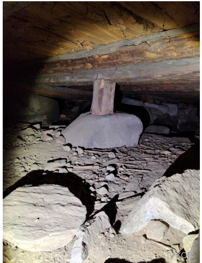
Kuva 6. Alapohjatilassa orgaanista materiaalia. Lattian kannattajia tuetaan pölkyillä kivien päältä.
