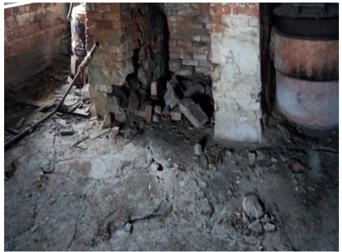
Kuva 120. Lattian pinta on vaurioitunut.
