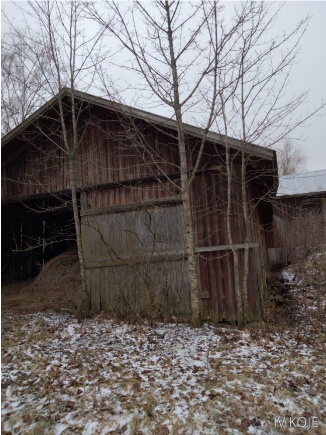
Kuva 59. Seinä liian lähellä maanpintaa.
