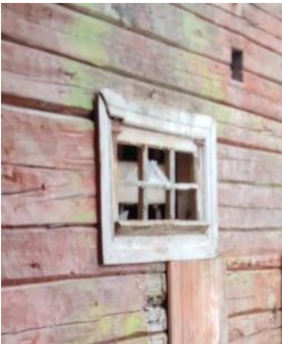
Kuva 105. Ikkunalasit ovat rikki.
