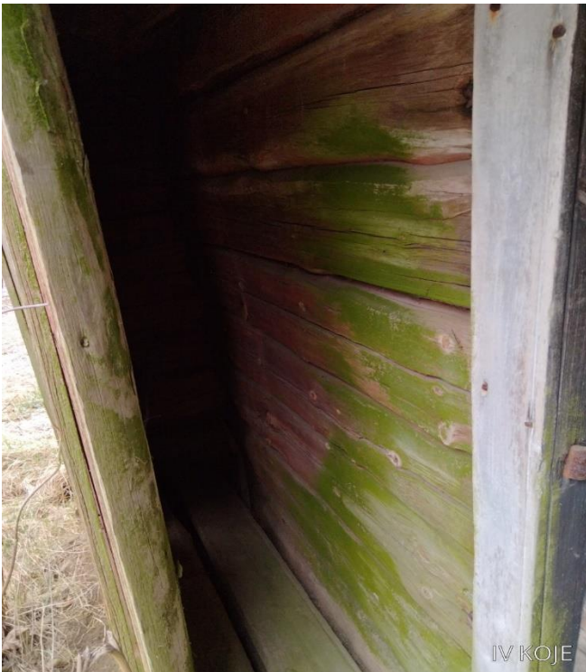
Kuva 53. Seinässä vihreää kasvustoa.
