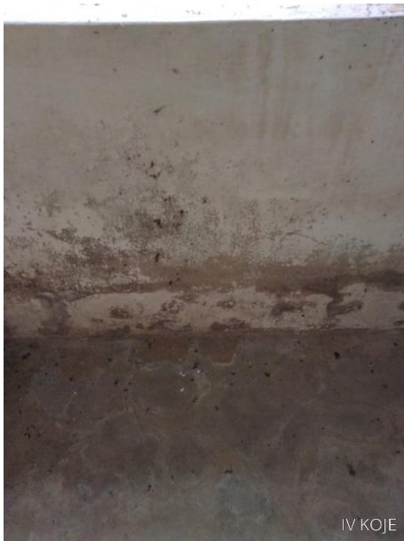
Kuva 10. Kosteusjälkiä maanvastaisessa seinässä.
