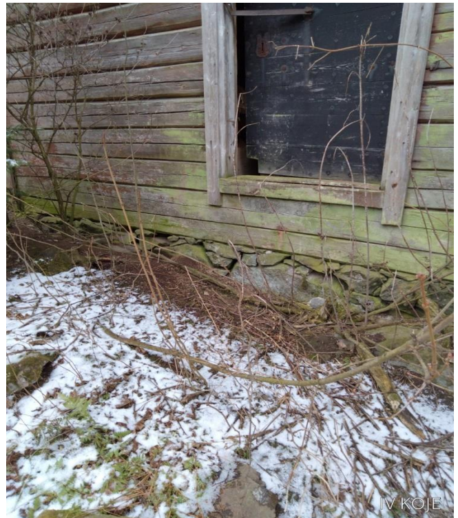
Kuva 51. Julkisivuhirret ovat nurkan kohdalla iinni maape- rässä.
