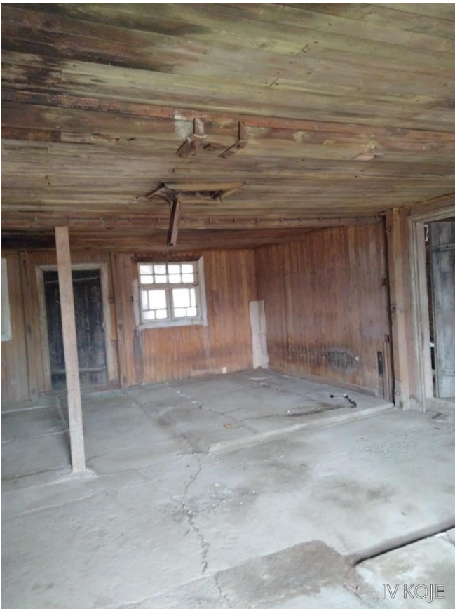
Kuva 112. Katossa on vuotojälkiä ja seinät ovat kuluneet ja lattiassa halkeamia.
