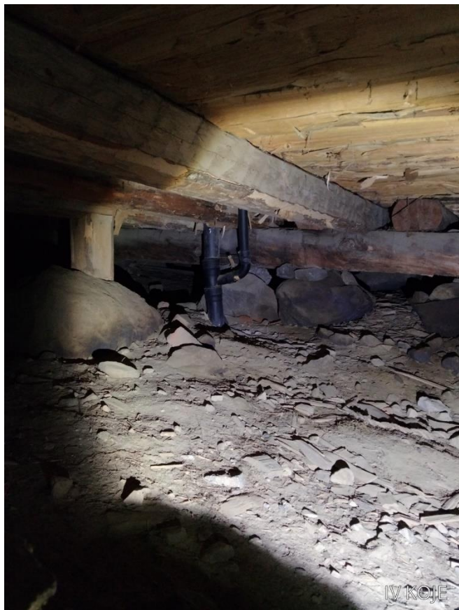
Kuva 127. Viemäriputket ovat valurautaiset.
