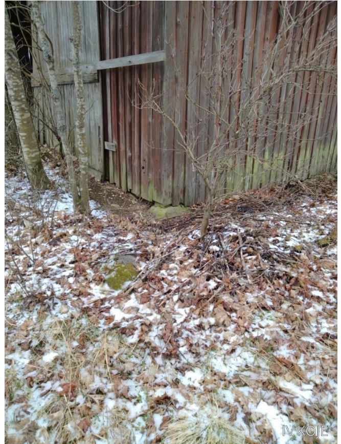
Kuva 60. Julkisivu vaatii kunnostusta.
