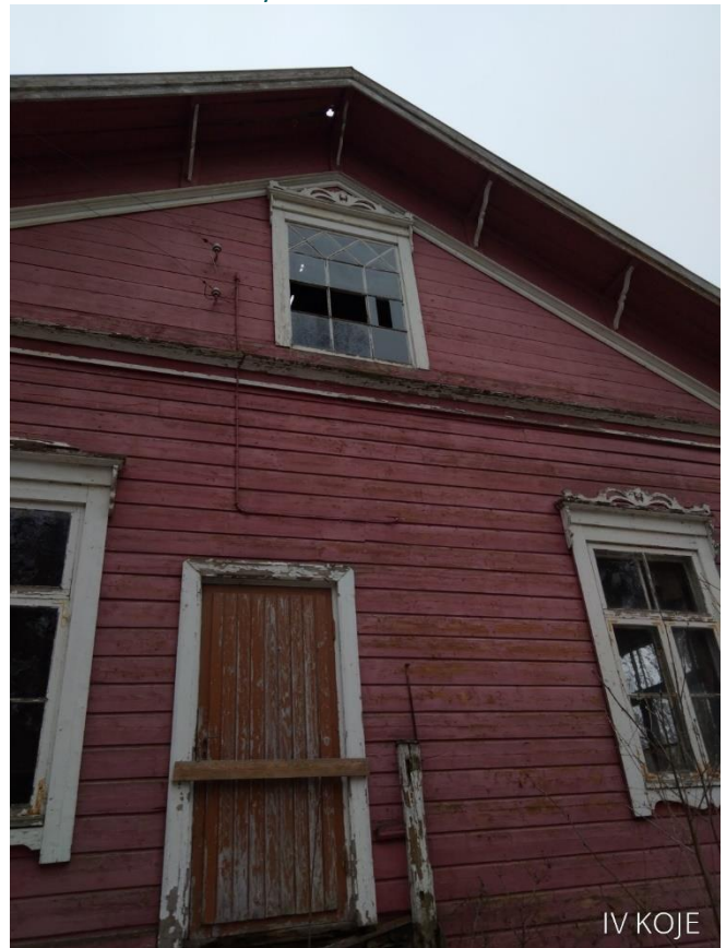
Kuva 70. Julkisivu on kunnostuksen tarpeessa.
