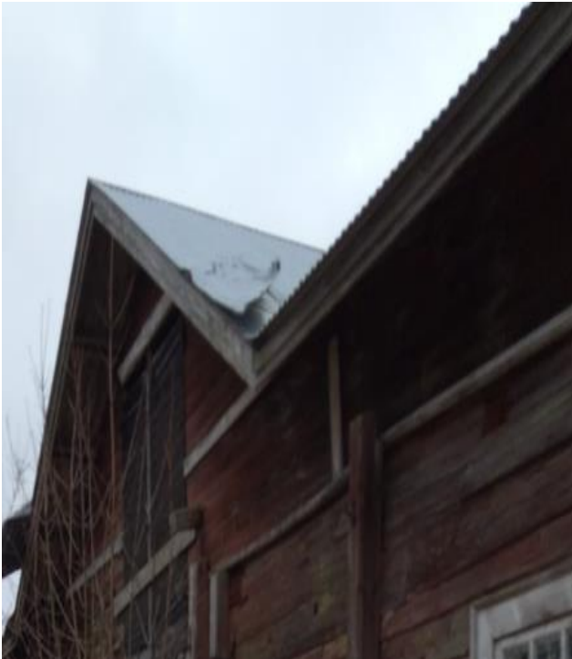
Kuva 19. Vesikaton aaltopelti on repeytynyt sisäjiiristä.
