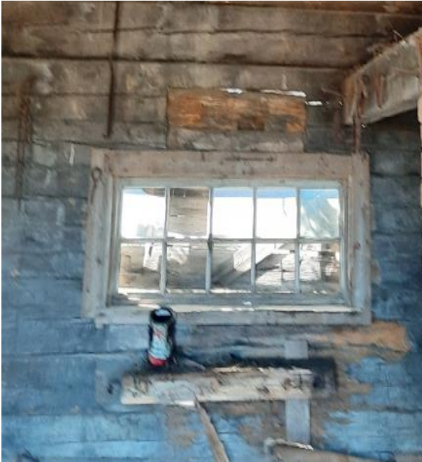
Kuva 40. Yksilasininen ikkuna vaatii kunnostusta.
