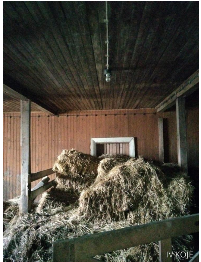
Kuva 113. Katossa likaa ja kosteusjälkiä.
