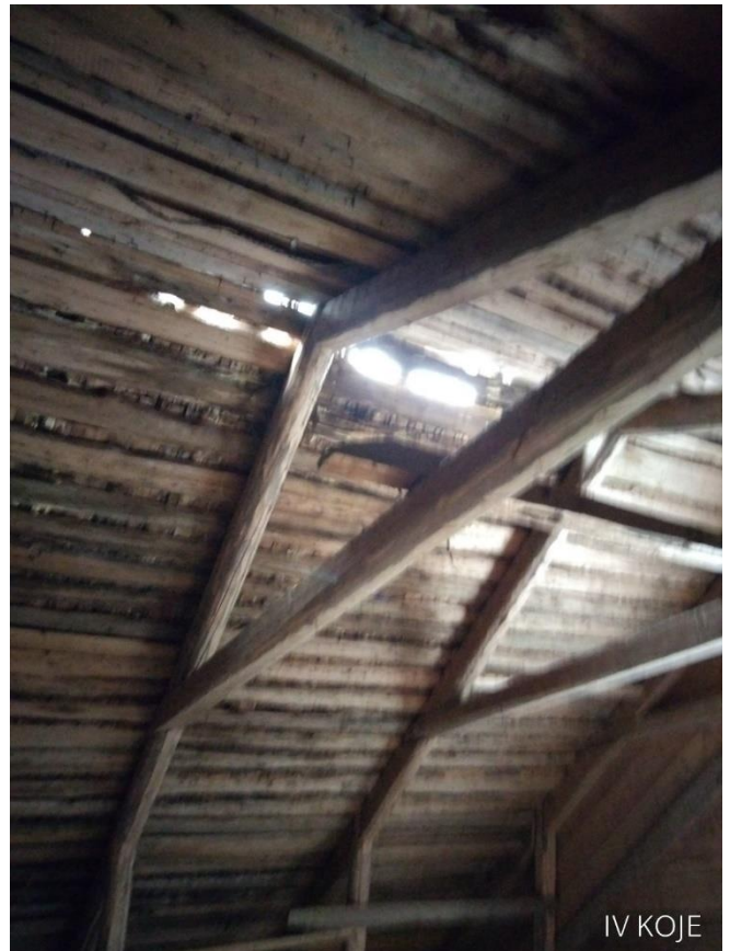
Kuva 74. Katossa reikiä, joista tuleva vesi kastelee rakenteet.
