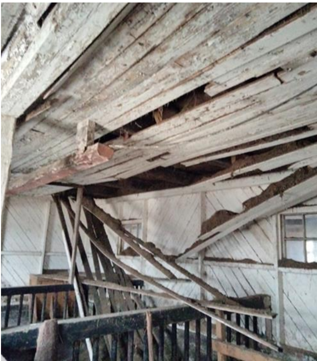
Kuva 25. Kattoa on romahtanut.
