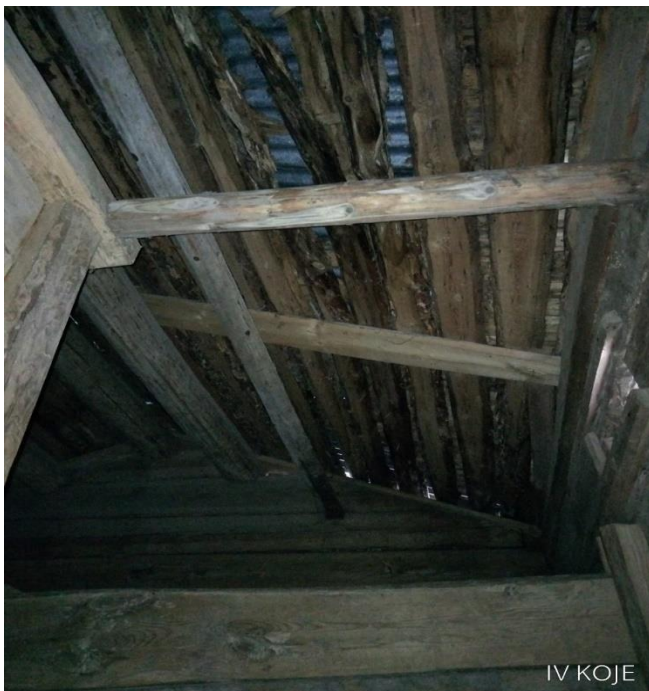
Kuva 56. Yläpohjarakenne, jota vesi on vaurioittanut.
