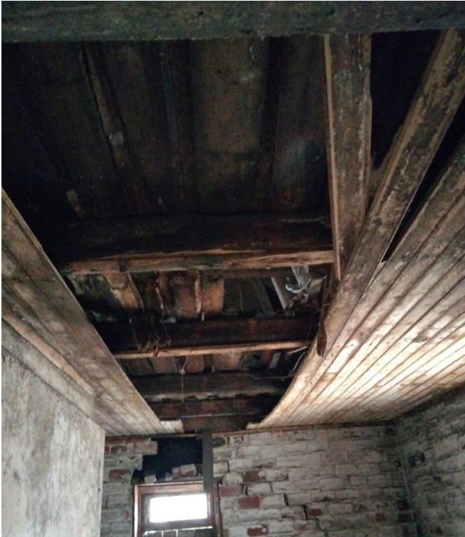
Kuva 23. Kattoa on romahtanut.
