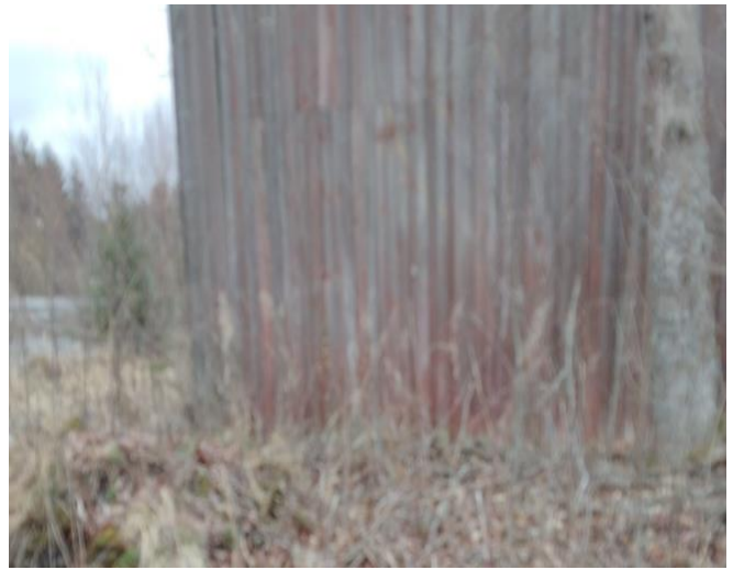
Kuva 33. Julkisivulaudat ovat kiinni maaperässä.
